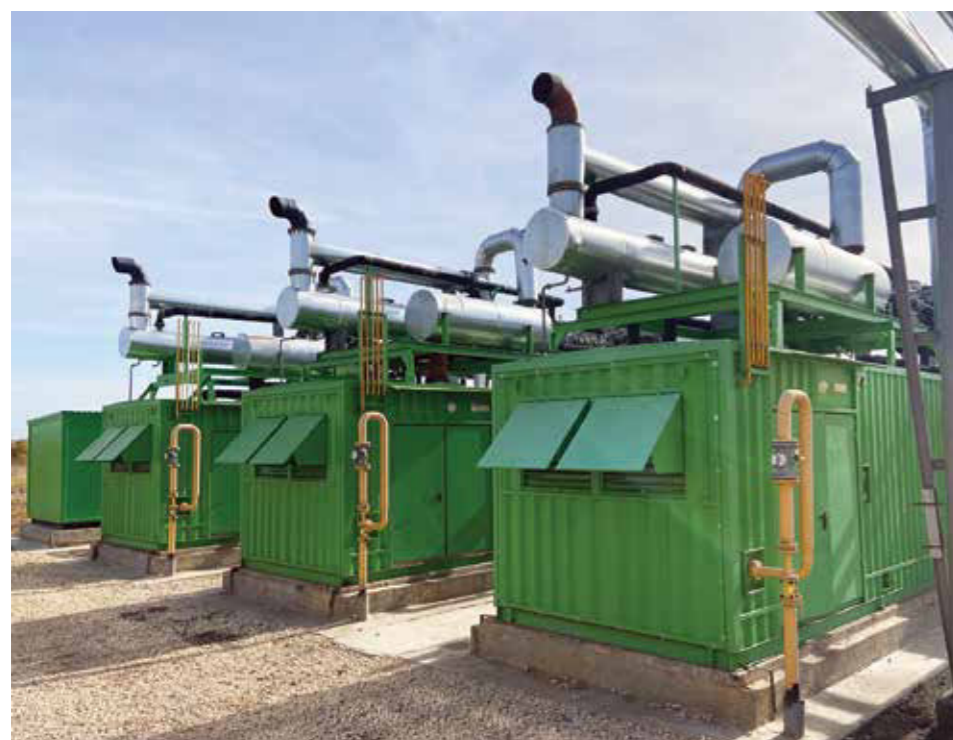
Блок-модуль я электростанция 2020
